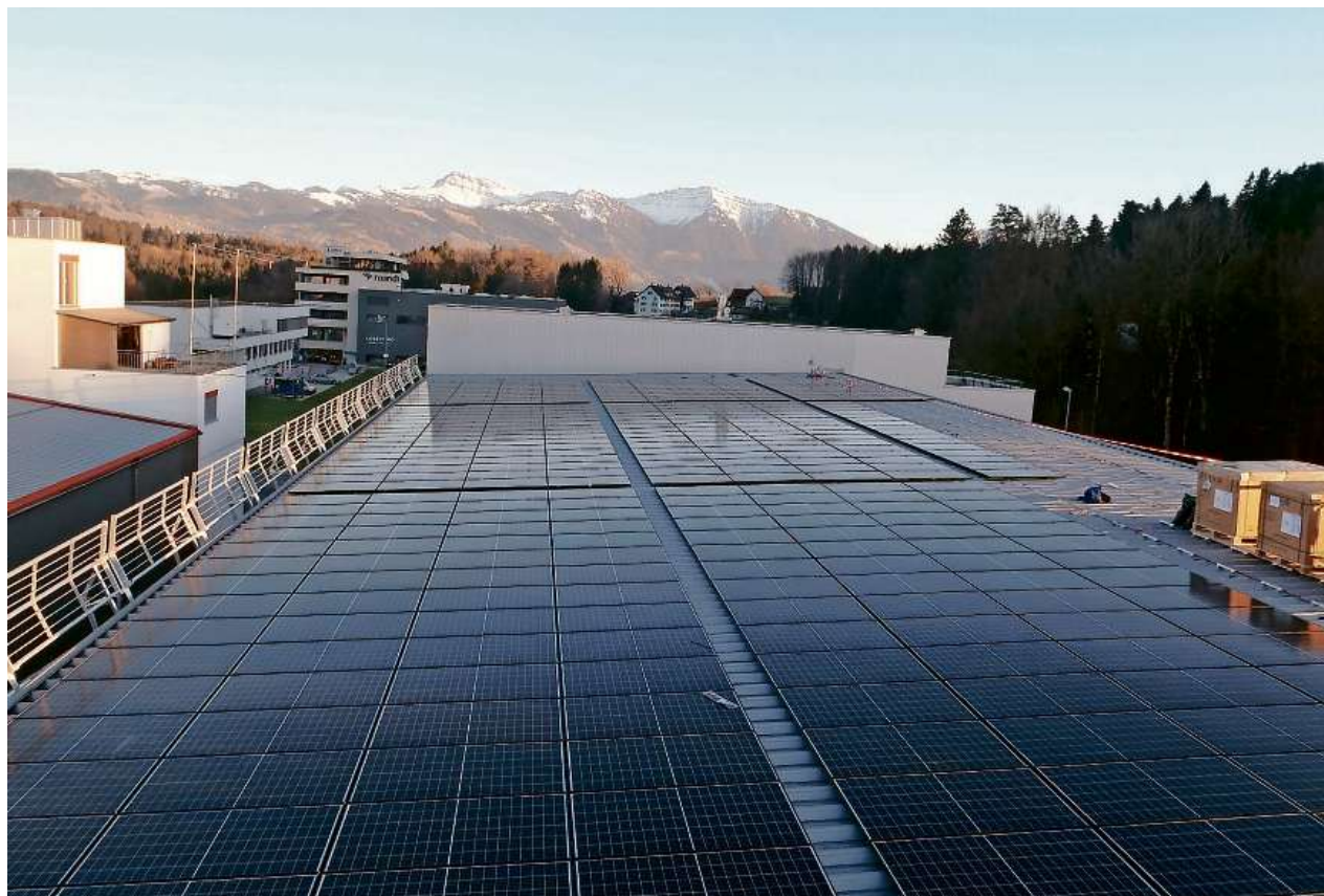
So gross wie eineinhalb Eishockeyfelder: Die neu gebaute Fotovoltaikanlage der Firma Oberholzer in Neuhaus.
